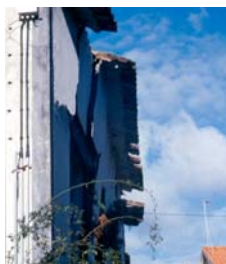
Figura 7: Rotura parcial ao nível da cobertura (Faial - Açores)
