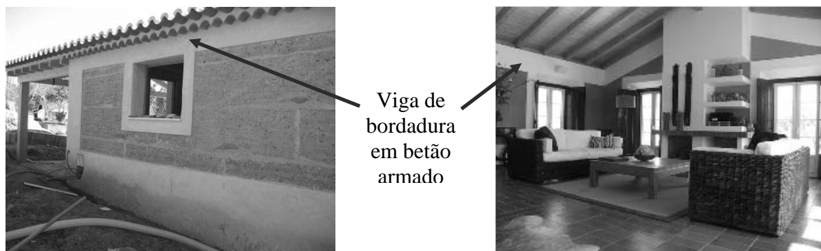
Figura 3 - Edificações com vigas de bordadura em betão armado: à esquerda, habitação e, à direita, habitação para turismo rural (Naturarte, 2007), ambas na localidade de São Luís - Odemira
