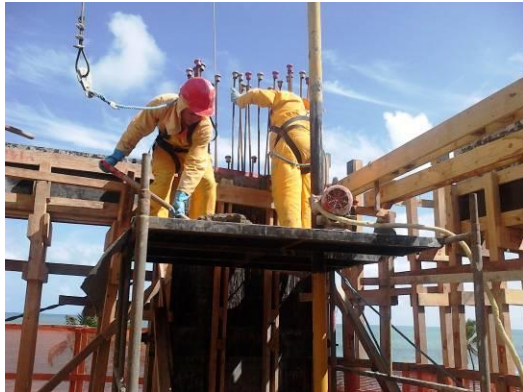
Figura 2 – Evento que gerou perda máxima em pilar na obra piloto de estrutura de concreto.
