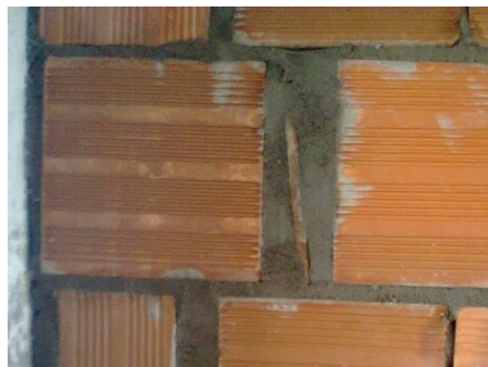
Figura 7 – Sobre-espessura da junta vertical na obra piloto de alvenaria de vedação.
